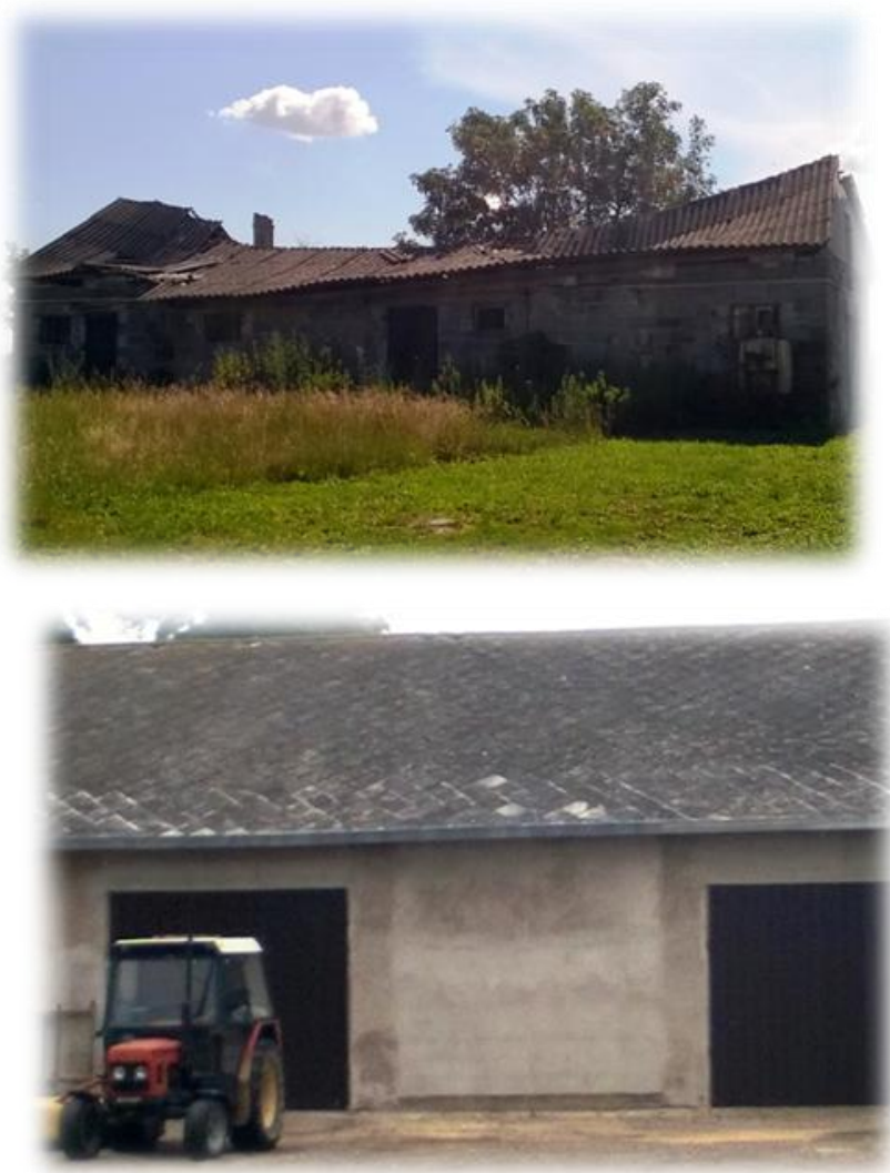
Rysunek 1. Wyroby azbestowo-cementowe: na górze z lewej- płyty faliste, na dole po prawej- płyty płaskie (źródło: materiały własne).
